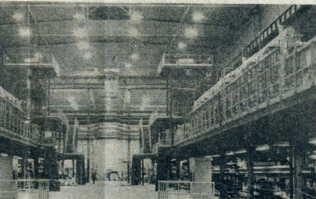
transformatorowych w Bochni
