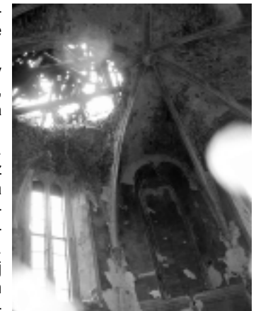
Obecny stan gotyckiego sklepienia bocznej nawy w kościele w Podhajcach
