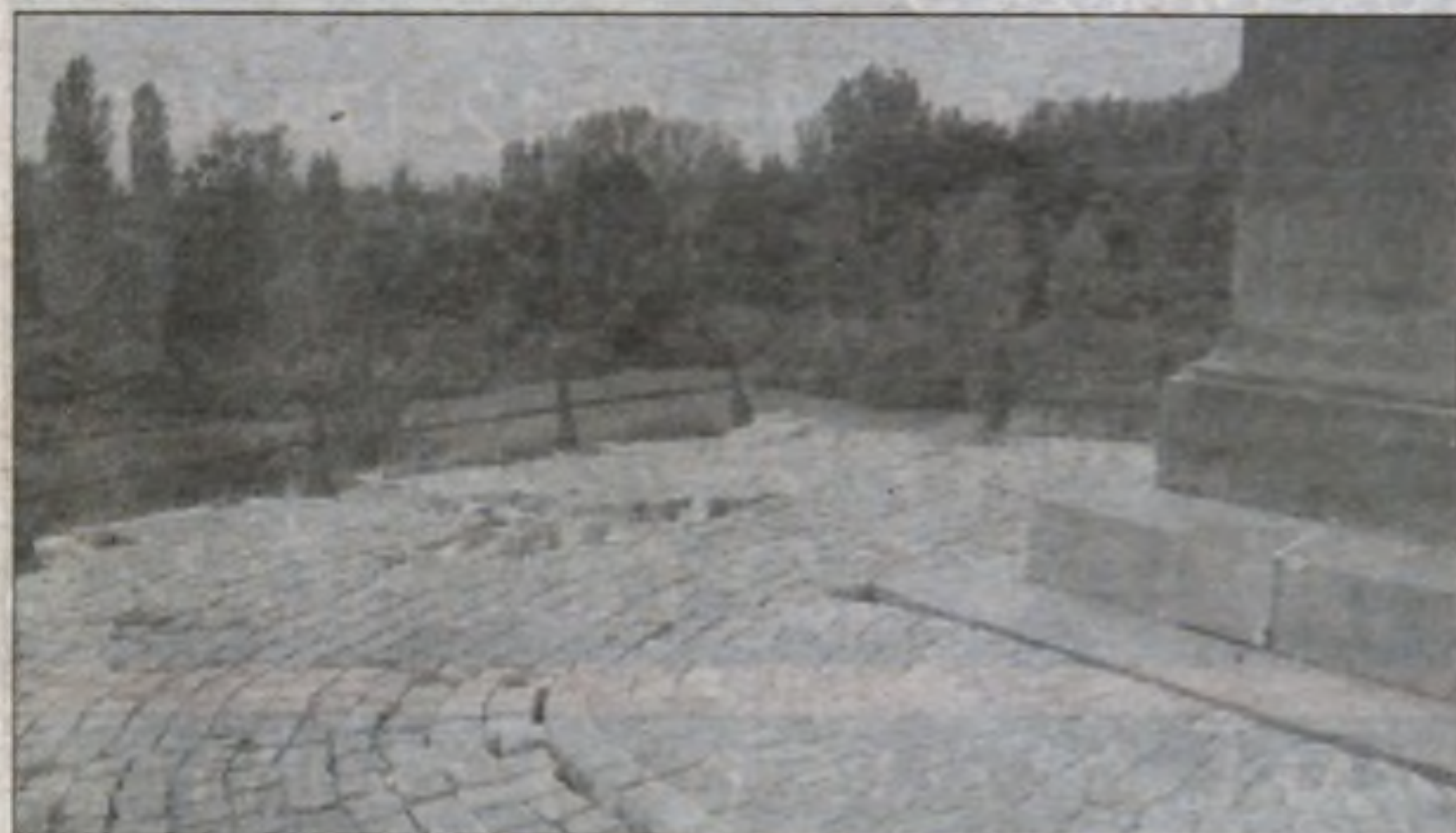
Zniszczony fragment nawierzchni kopca i widoczne półkoliste rozpadliny.
