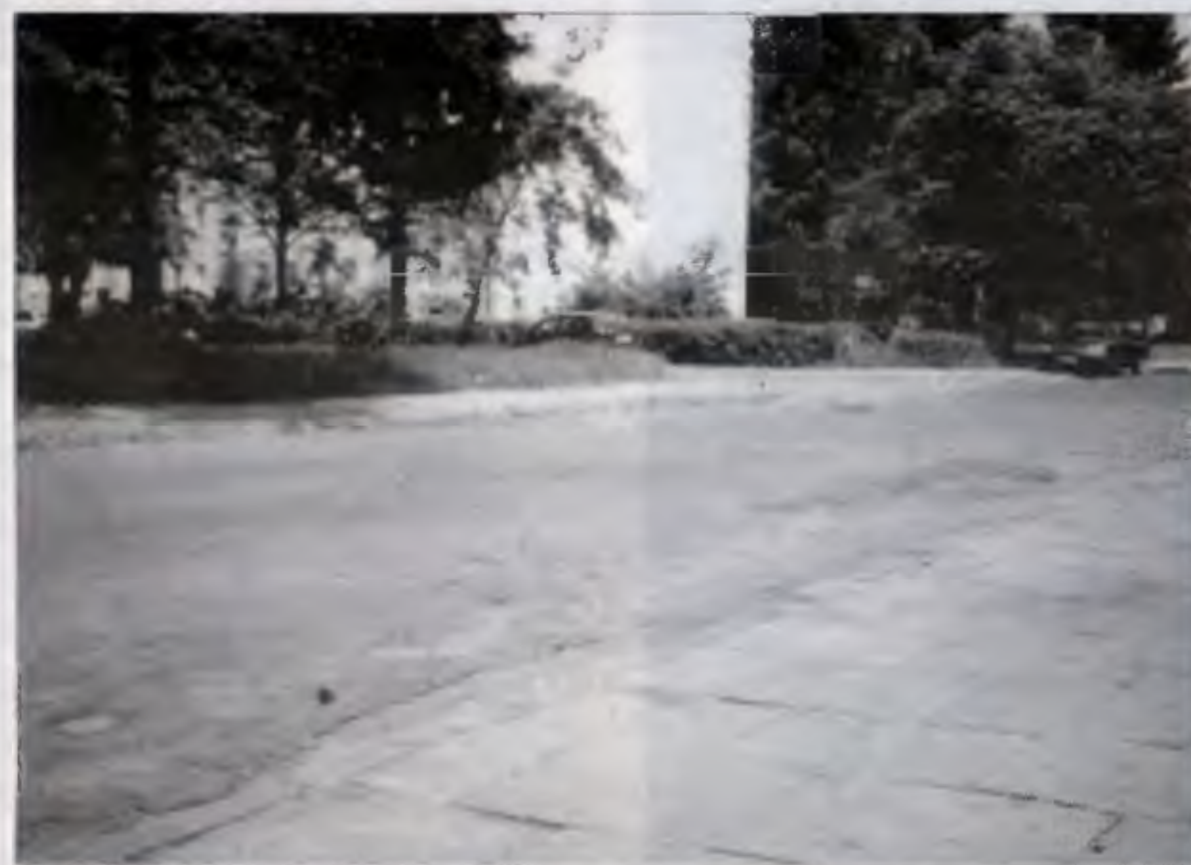
Przy ul. Wiśniowy Sad brakuje miejsc parkingowych, a stan nawierzchni wewnątrzosiedlowej drogi jest fatalny.
