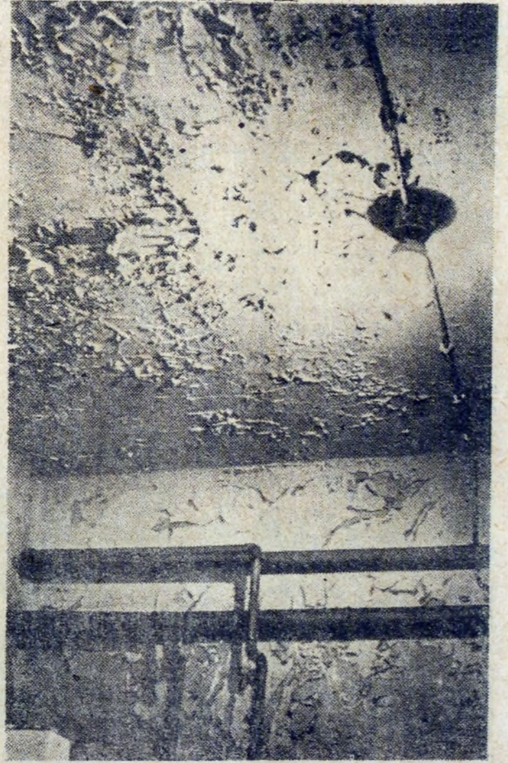
A oto ściany i sufit w łaźni. Zniszczenie jak po przejściu huraganu.
