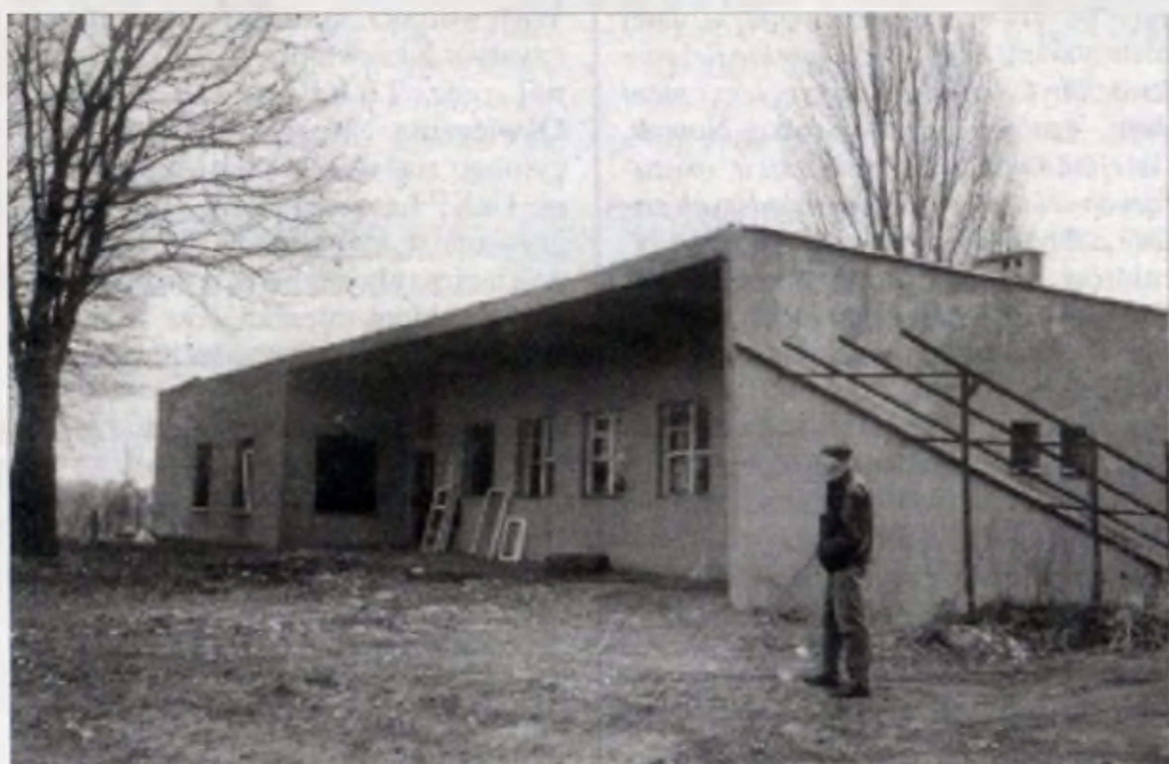
Kazimierz Pająk, emerytowany pracownik PKP, pokazuje dewastację „kolejowego” majątku. Z budynku pozostały tylko mury...
