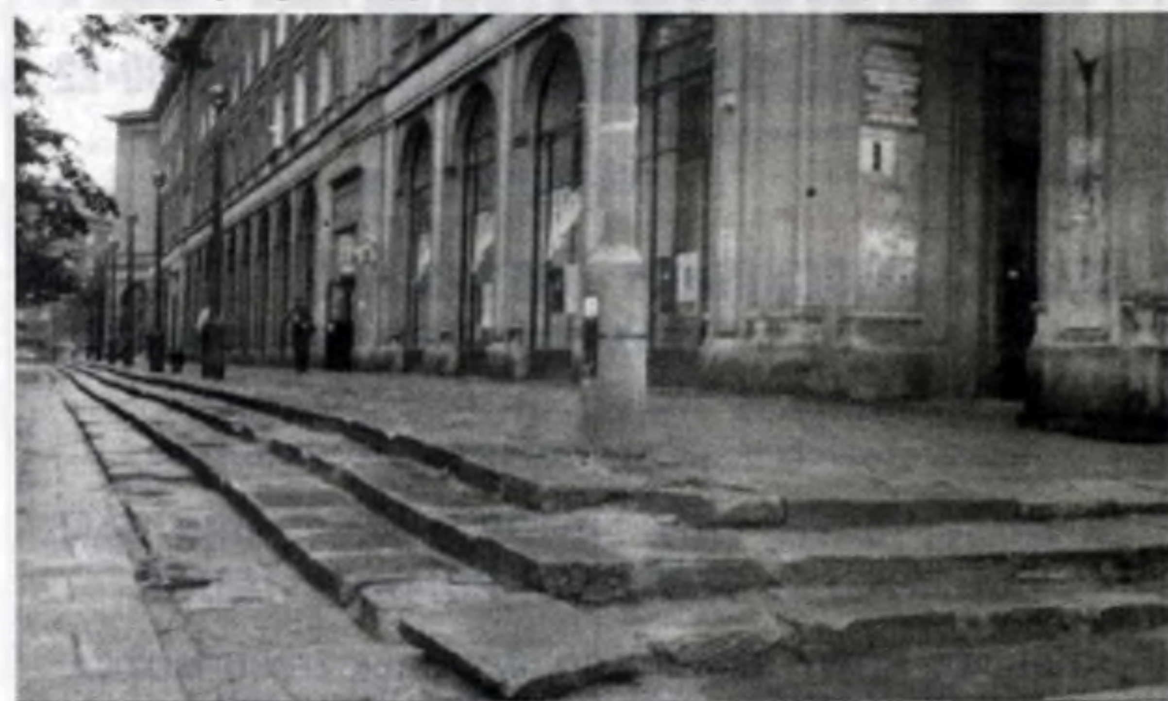
Tarasowe schody są w fatalnym stanie.
