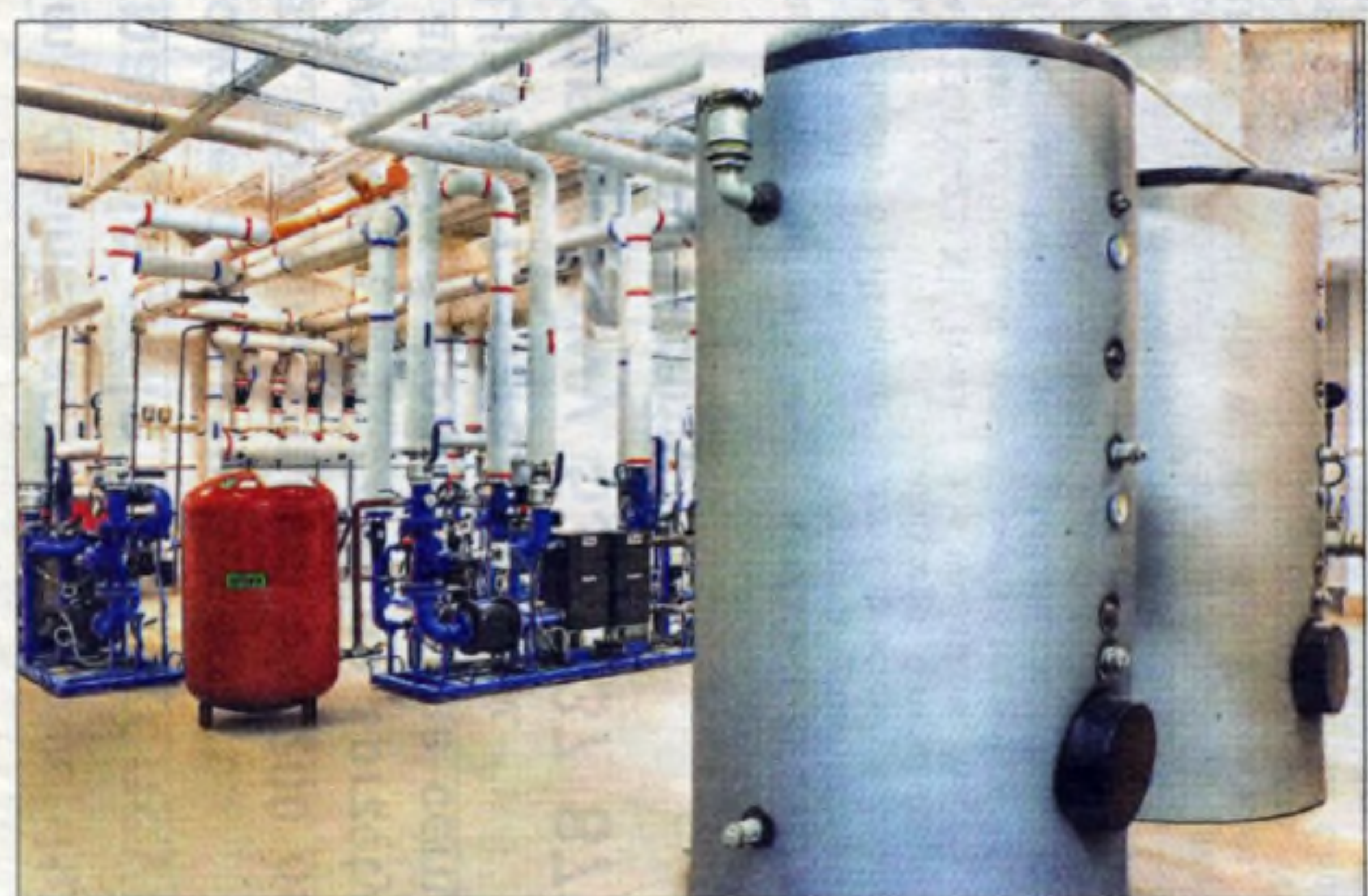
Nowoczesny węzeł cieplny.
