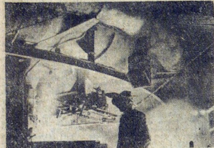
Zdjęcie podobne do sceny z fantastycznej bajki lub do ciekawego obrazu nieznanego artysty. A to tylko praca przy wielkim piecu nr IV, niedawno gruntownie (i przedterminowo!) wyremontowanym.
