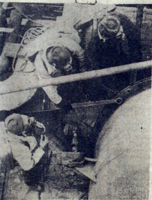
Pełne napięcia chwile na rurociągu, w którym pod normalnym ciśnieniem płynie gaz. Foto: St. Gawliński
